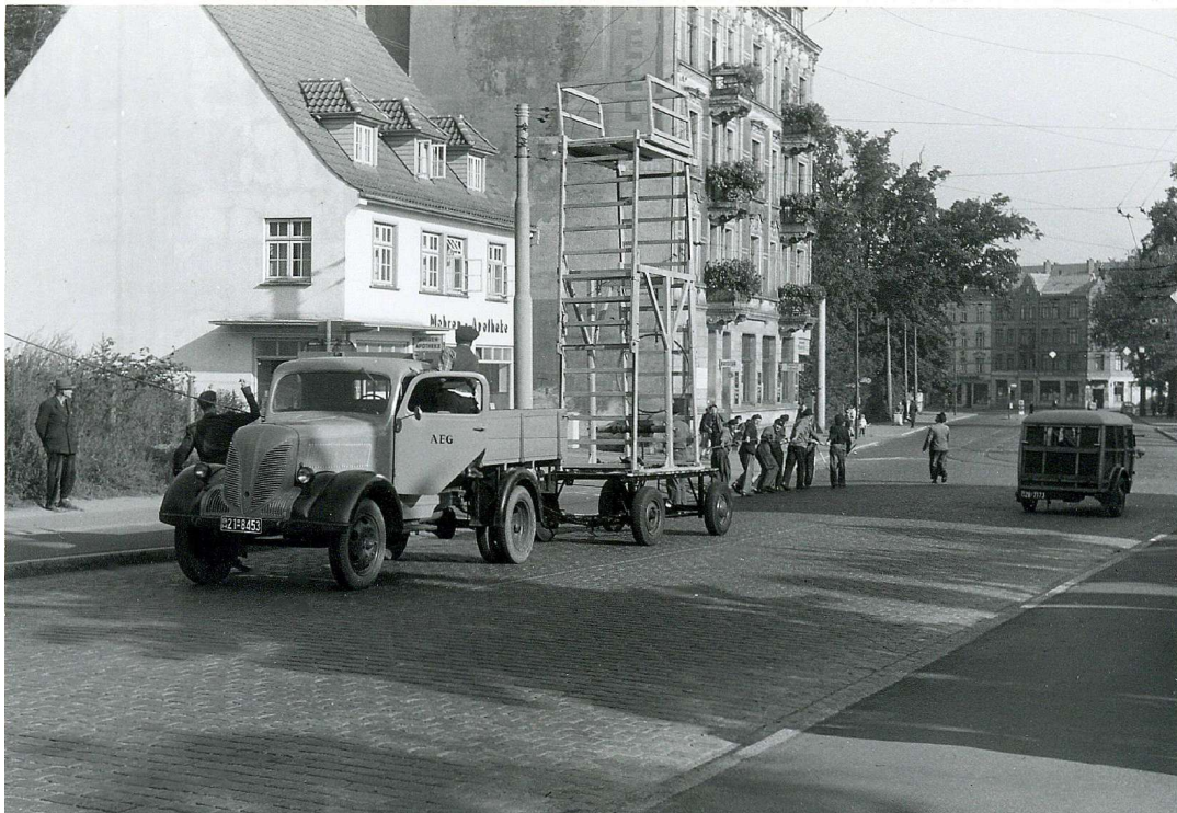
Bau der Obusstrecke nach Fleestedt. Fahrleitungsarbeiten durch Mitarbeiter der AEG in der Winsener Straße, Nähe Betriebshof Harburg. Foto: HHA, 17.9.1952
